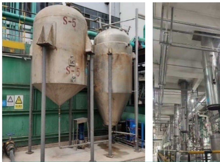
冷凝水余热回收系统
